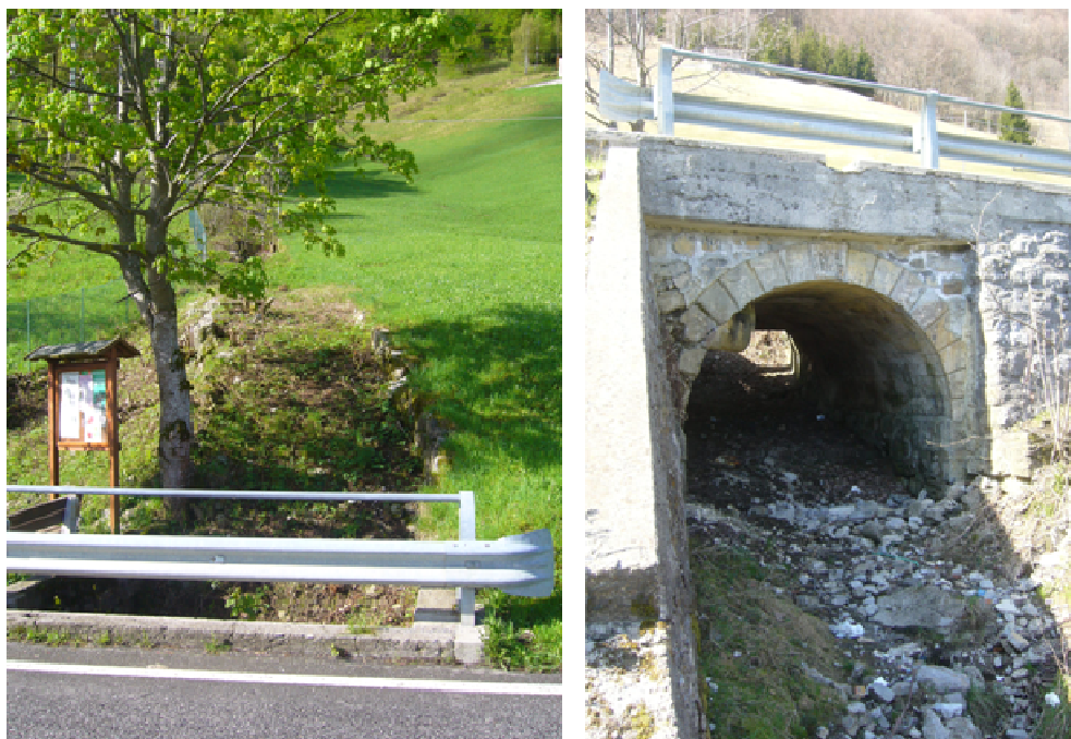
Fig. 1: impluvio del torrente Valle Cedrone in prossimità del ponte sulla S.P. n°16.
